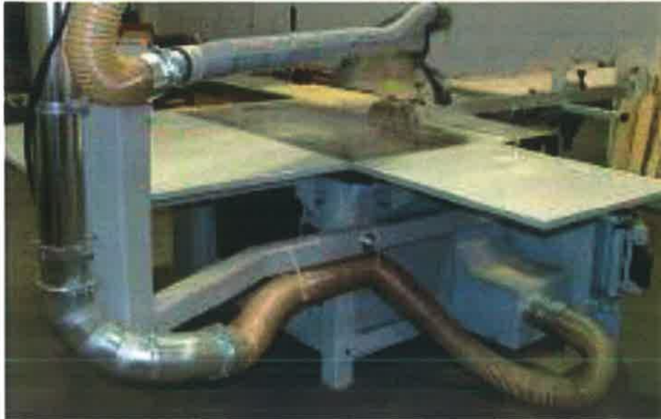
Rys. 2.8. Widok układu odpylania od strony króćców, [2].
